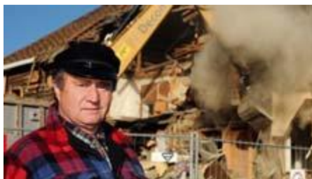
OPPRØRT | Leder av Blaker og Sørums historielag, Dag Winding-Sørensen, mener rivingen av Nordli var bevisst hærverk. Vidar Sandnes | foto
