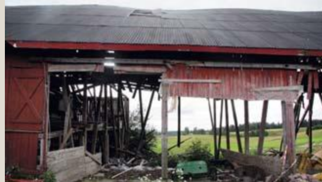
FÅR IKKE RIVE | Låven på Hillern Gård på Kløfta er motsatsen til hovedbygningen på Nordli. I juli skrev RB at grunneieren ikke fikk lov av fylkeskommunen å rive, tross hvor dårlig stand låven var i. Rivningssøknaden er nå trukket, og grunneieren skal forsøke å få i stand deler av låven.
