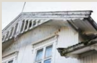
BEVARING | Det gamle herredshuset i sentrum av Aurskog er regulert til bevaring. Likevel bærer det tydelige spor etter mangel på vedlikehold. For eksempel gror det godt i takrenna.
