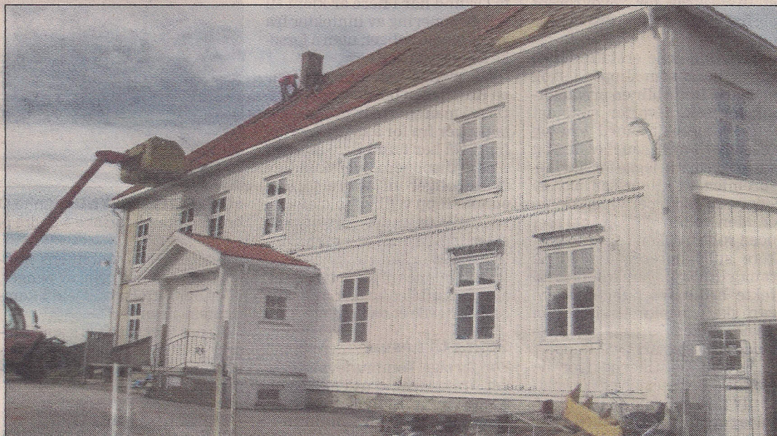
RIVES: Lørdag ble det startet med å fjerne takstein. I dag skal bygningen rives. Er det mulig at noen tar til fornuft før varige historiske verdier forsvinner, spør innsenderen.
